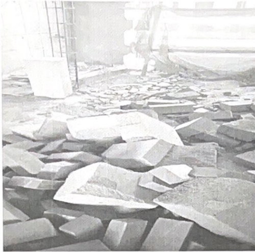
北阳台变砌体变更护栏照片
