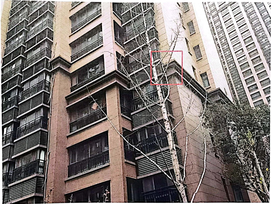
36#南立面 1/Q 轴 4 层至 5 层层间腰线漏水，重新翻修，挂网抹灰，喷涂岩彩漆，长 12.94 米，展开高度 0.95 米。
