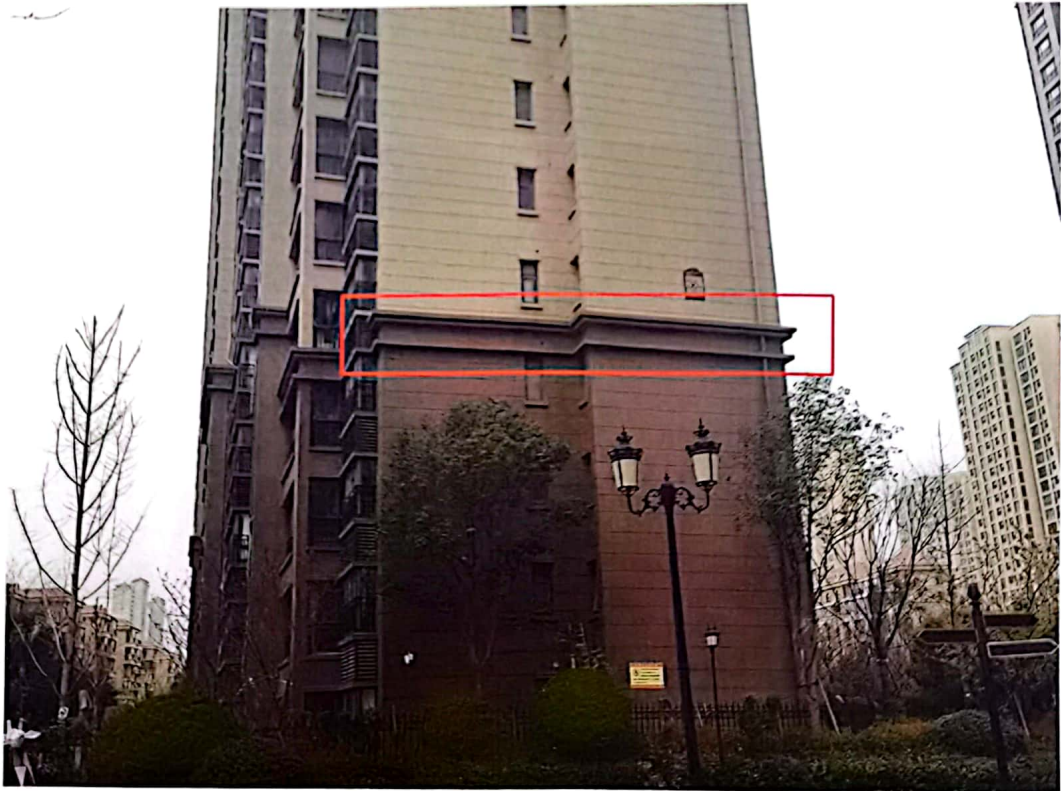
36#东立面 1~2 轴/E~Q 轴 4 层至 5 层层间腰线漏水，重新翻修，挂网抹灰，喷涂岩彩漆，长 12.94 米，展开高度 1.71 米。
