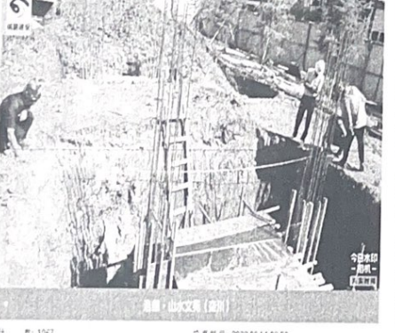
计 数: 1067 施工区域: S1-东大门 施工内容: 土方收方 拍摄时间: 2022.08.14 08:52 天气: 多云 30°C 地点: 崇川区·008乡道
