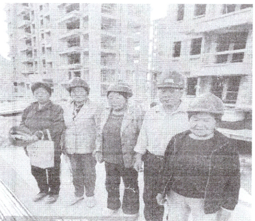
工程记录 施工内容: S7地块, 下沉庭院垃圾 清理 拍摄时间: 2025.05.14 07:36 地点: 我在这里
